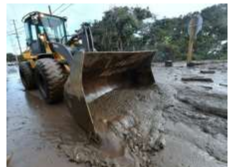
Inondations janvier 2014 (Hyères)
