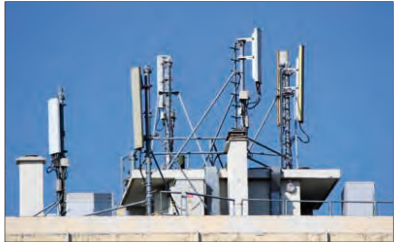
Document 2 Un relais de téléphone sur une toiture
